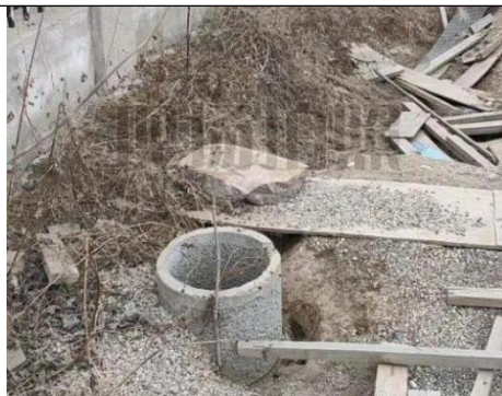
地下水监测井
